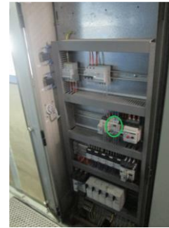
Habitáculo del armario Top abierto. Sobre la imagen el magnetotérmico Q100/Top cabinet open. In the picture, the circuit breaker Q100 is highlgheted
