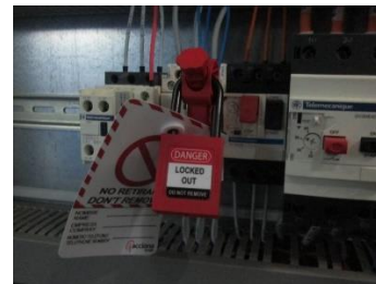
Consignación del magnetotérmico abierto/Lock out Tag out in Circuit Breaker open
