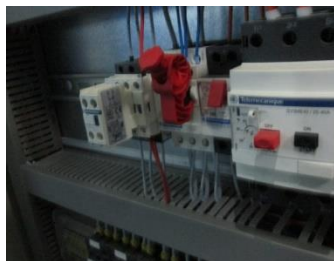
Instalación del sistema de bloqueo/Lock system installed
